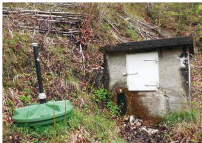
Abbildung 6: Ein betonierter Quellschacht und ein Quellschacht in Kunststoffausführung (© Stefan Hellebart)
