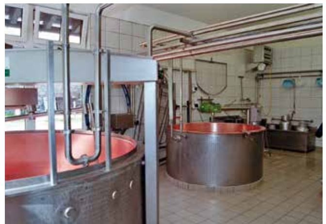
Abbildung 6: Verarbeitungsraum einer Almsennerei (© HBLFA Tirol)
