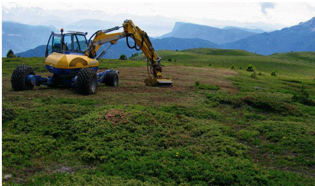
Nach anfänglichen Versuchen, Zwergsträucher und Krummholz manuell zu entfernen (o.), ging man in der Zwischenzeit auf den bodenschonenden Einsatz des Baggers mit Mulchaufsatz über (o.).
