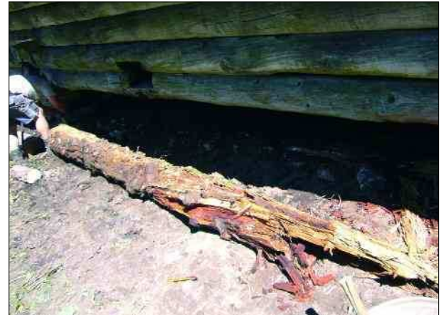
Das unterste Bloch war morsch und musste ausgetauscht werden
